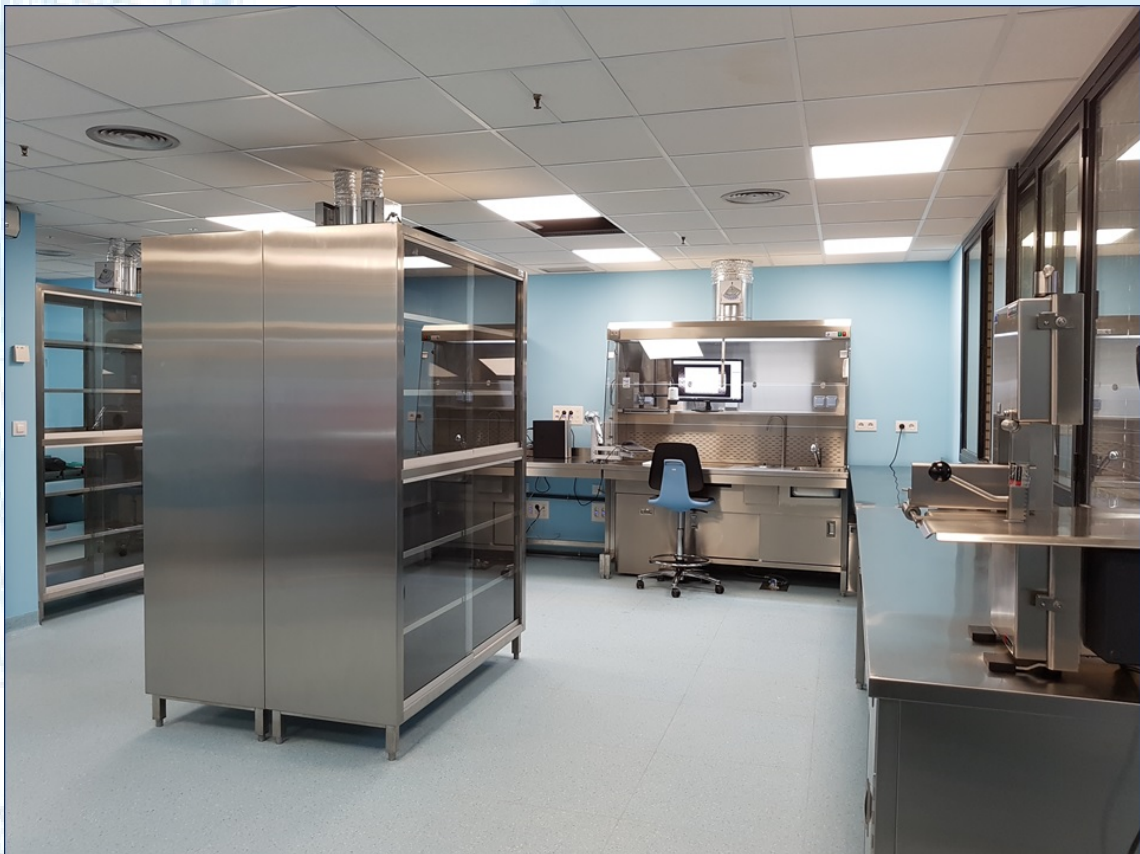
Armarios conectados al exterior mediante sistema de extracción en cubierta
